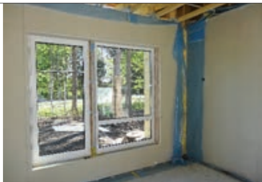
▲ Seinapaneelide liitekoht, mille tihendamistööd polnud foto tegemise ajal alanud.
