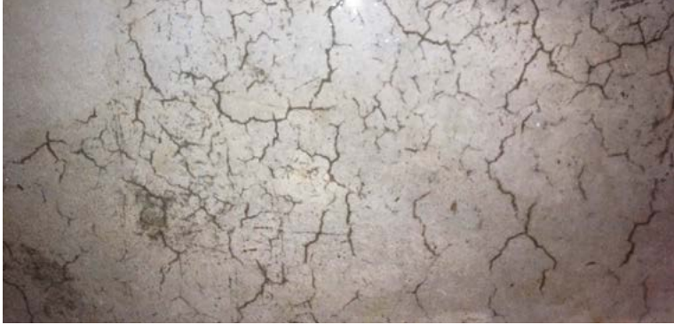
PILT 6: Plastse kahanemise praod masinhöõrutiga töödeldud pindadel. Masinhöõrutiga pinnatöötamise ajal on praod suletud, kuid need muutuvad aja möödudes taas nähtavaks, eriti, kui betoonkonstruktsioon kuivab edasi ja seeläbi kahaneb või kui betoonpind niiskub.
