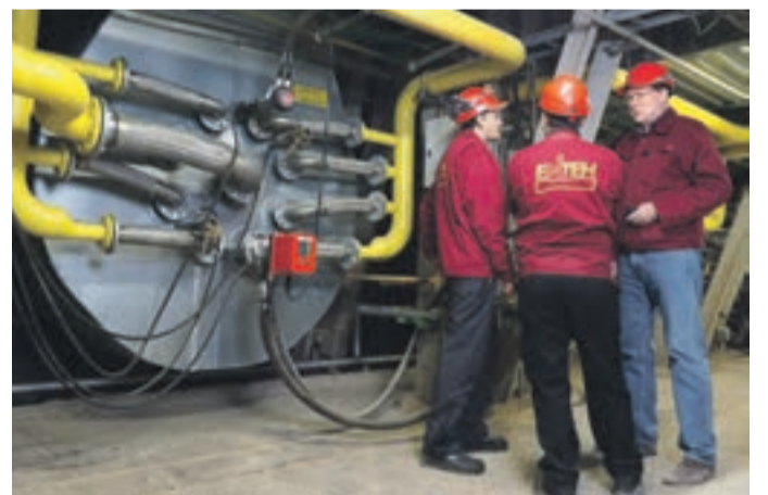
▲ ENTEH põletid Eesti elektrijaama katlal 5A.
